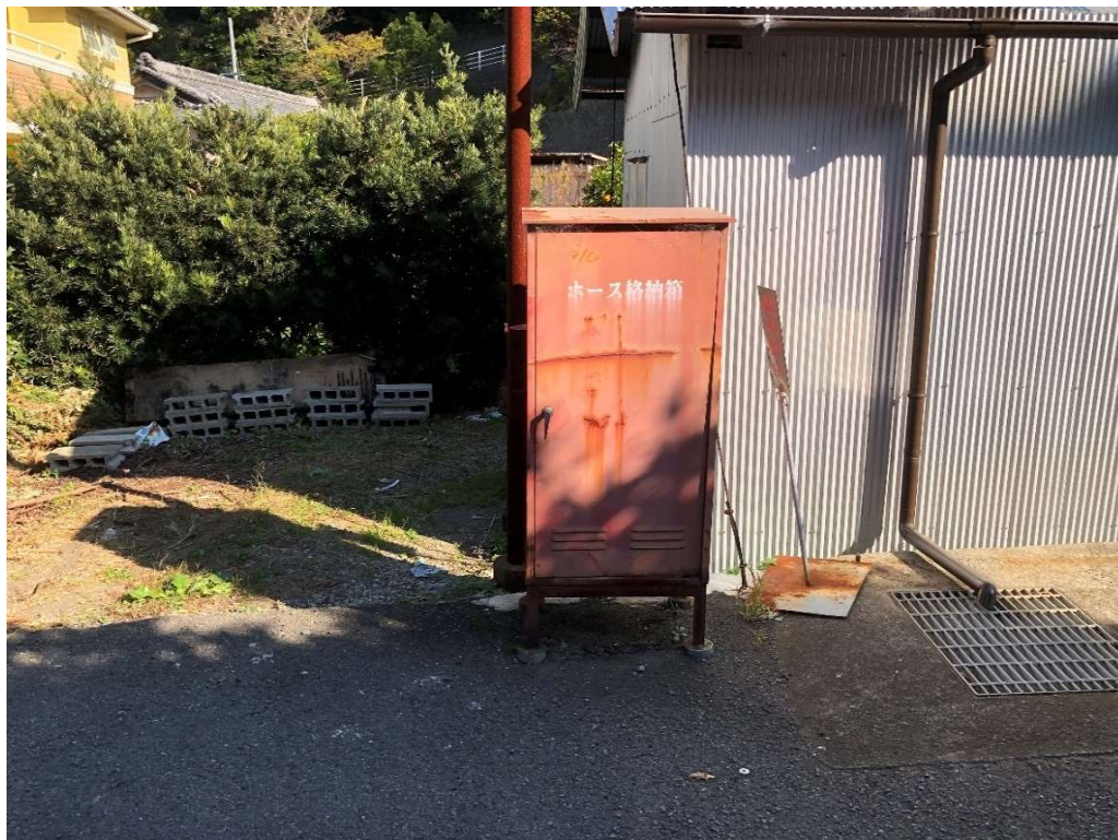
ホース格納庫 No.9：浄妙寺 12月10日
