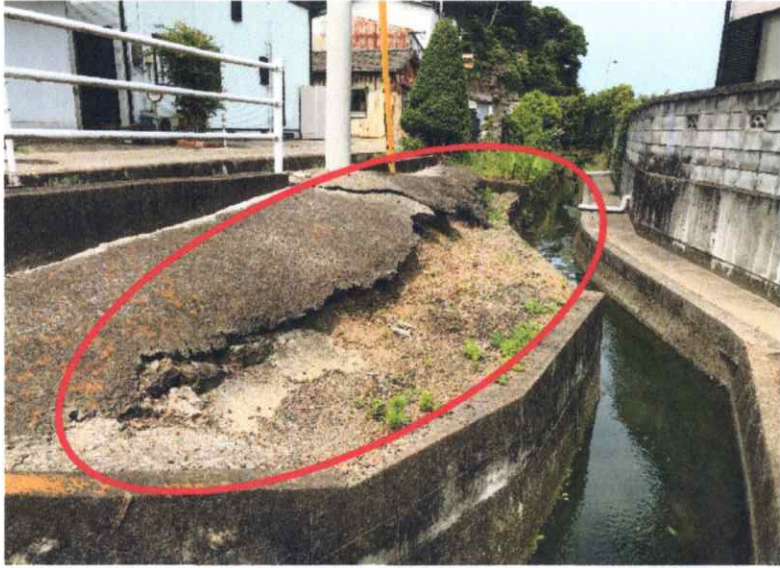
土砂崩れ の恐れ
